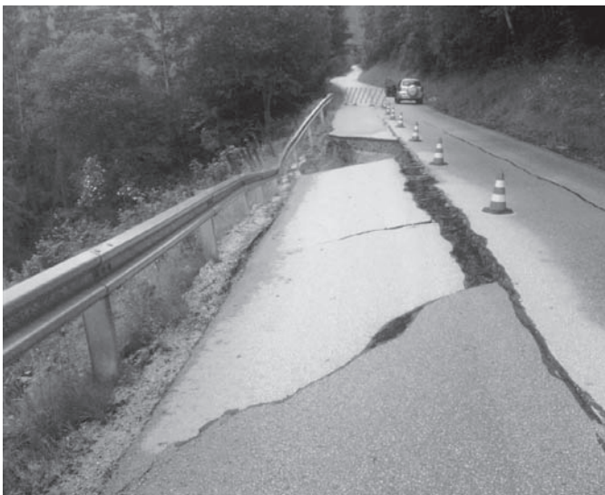
Schwere Schäden auf der Planneralmstraße
